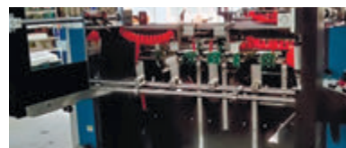
Секция автоматической приемки
